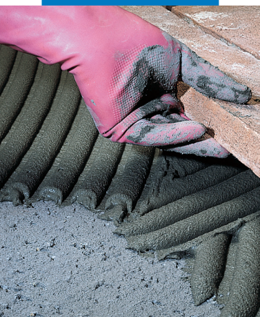
Colocación de terracota con mezcla desigual
